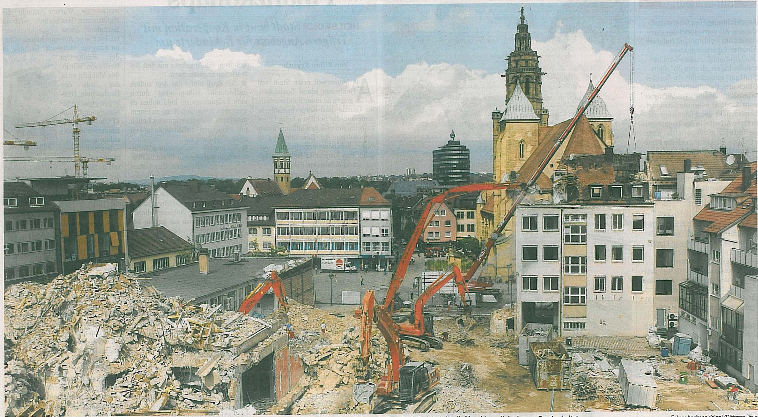
Das spannende Spektakel hat bald ein Ende: Bis heute Nachmittag soll das letzte mehrstöckige Klosterhof-Gebäude gefallen sein. Damit ist die Arbeit für die Maschine mit der langen Front erledigt.
