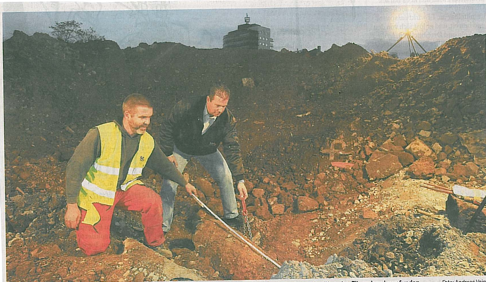
Erste Kontrolle durch Kampfmittel-Experten: Auf dem alten RBS-Gelände in Heilbronn wurde am Montagnachmittag eine Fliegerbombe gefunden.
